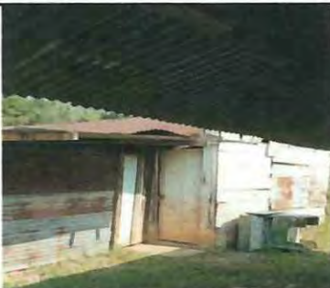
Foto 5: IMAGEN DEL CORREDOR DONDE SE PUEDE OBSERVAR LAS LAMINAS EN MAL ESTADO.
